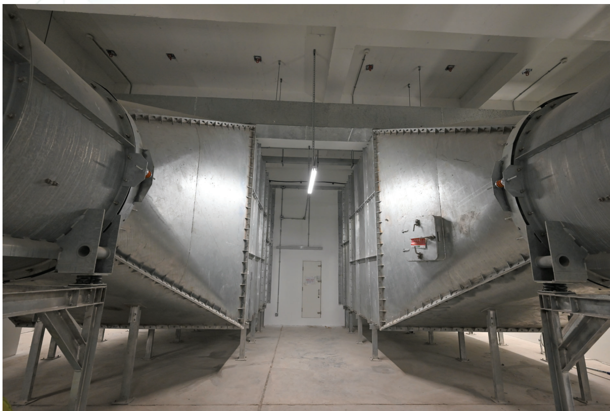
隧道通風風扇 Tunnel ventilation fan
